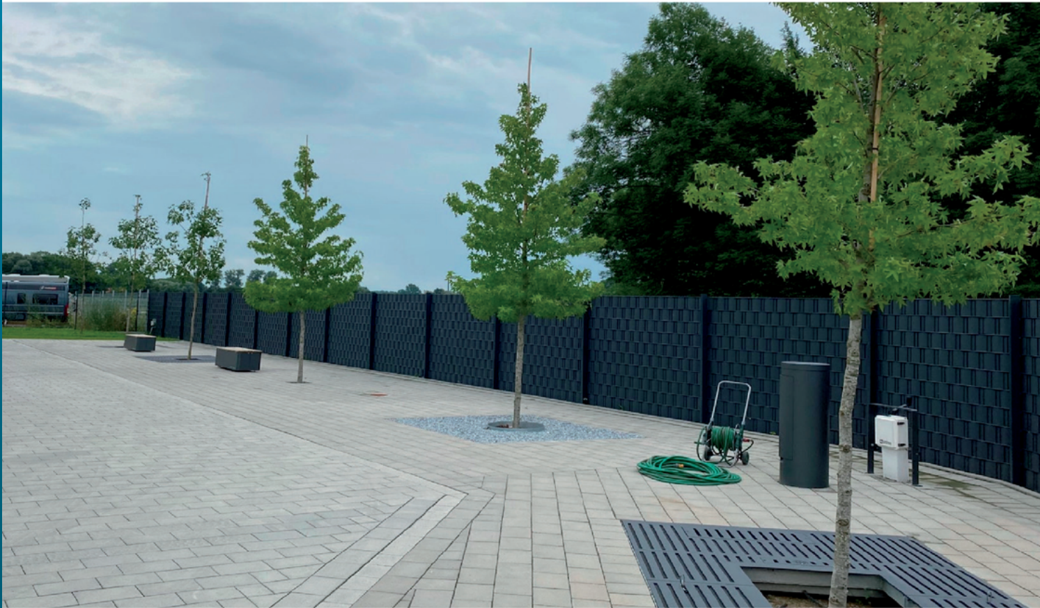
Abb. 3: Baumrigolen nach dem Einbau | Foto: Grüning, FH Münster
