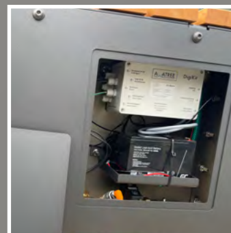
Steuereinheit (optional) im Trockenbereich der HUNO® Tankbank zur digitalen Ventilsteuerung
